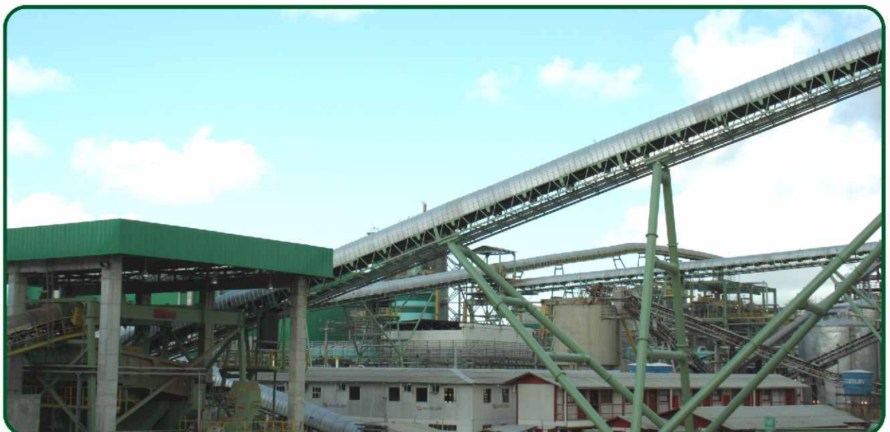
Chip conveyors at the chipping area / Transportadores de cavaco da área de picagem
