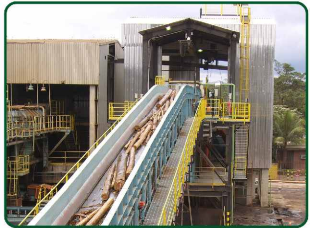
Log Conveyors / Transportador de Toras
